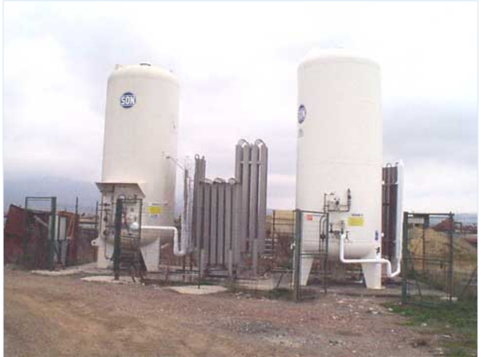
Serbatoi di ossigeno liquido
